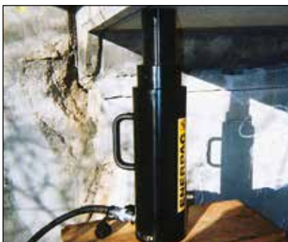
◀ Un cilindro in alluminio con ghiera di sicurezza RACL-1506, sostiene il carico durante l'operazione di iniezione di resina epossidica per il rinforzo di un ponte.
